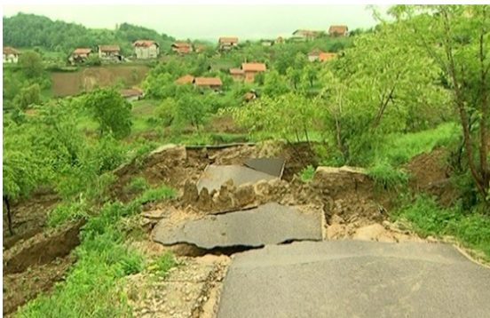
Kalesija, klizištem uništena cesta
